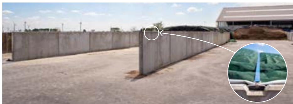
De vroegere autobanden om de silo's luchtdicht te houden zijn vervangen door spanbanden, waarvoor er in de betonnen wanden speciaal ijzers werden voorzien. Netten beschermen het plastic tegen vogels en voorkomen scheuren bij het aanspannen.
